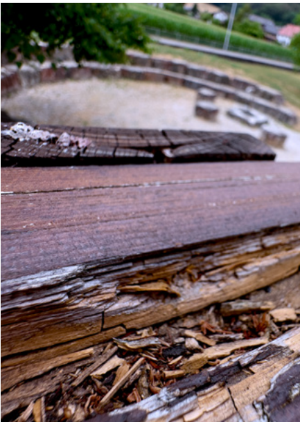
Die morschen Balken sind ein Sicherheitsrisiko.
